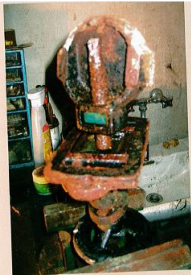
Alkuperäinen viemärin sulku- venttiili.
